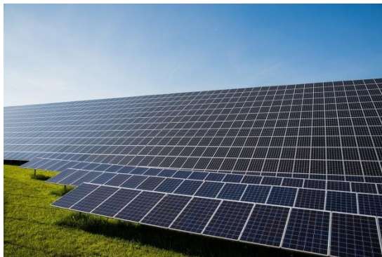
Рис. 1. Солнечные фотоэлектрических установки
