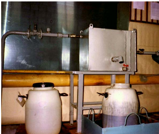
Рис. 2. Установка «Флотатор-У» подключенная к системе очистного сооружения.
