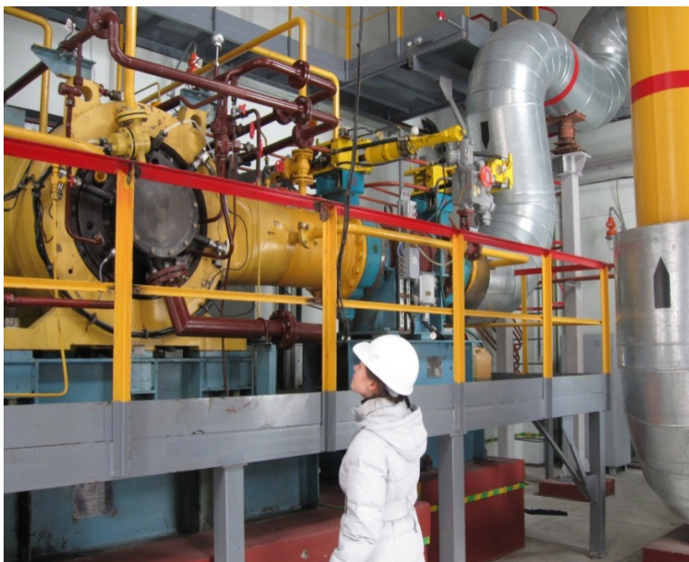
Рис. 2. Помещение детандерного отделения на Гомельской ТЭЦ
