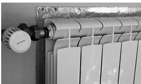
Рисунок 4 – Теплоотражающие экраны за отопительными приборами Источник: [7]
