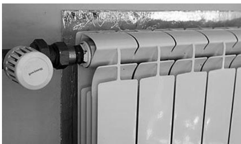
Рисунок 4 – Теплоотражающие экраны за отопительными приборами Источник: [7]
