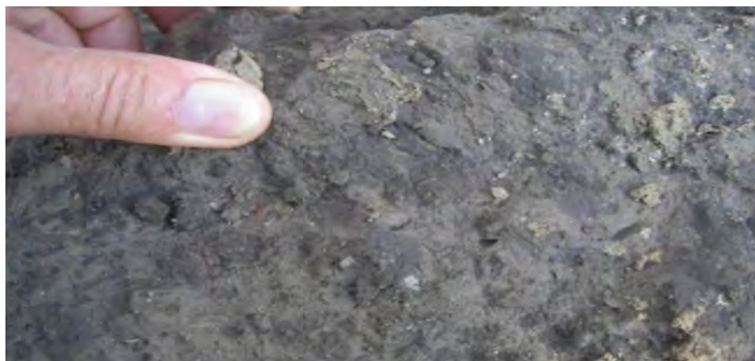
Рис. 2. Структура грунтоцемента при двукратной проходке и скоростях вращения инструмента 35 об/мин. и осевого перемещения, 5 м/мин.
