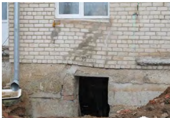
Рис. 2. Общий вид поврежденной стены (трещины заделаны раствором)
