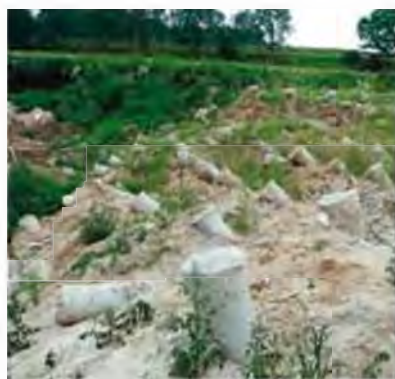
Рис. 8. Разрушение голов столбов в результате перемещения масс слабого грунта
