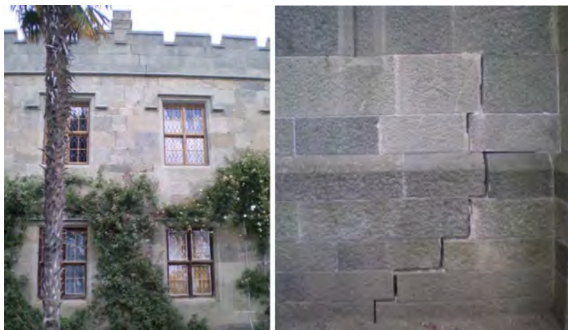
Рис. 3. Последствия неравномерных осадок фундаментов вследствие искусственного обводнения грунтов. Воронцовский дворец, п.г.т. Алушка
