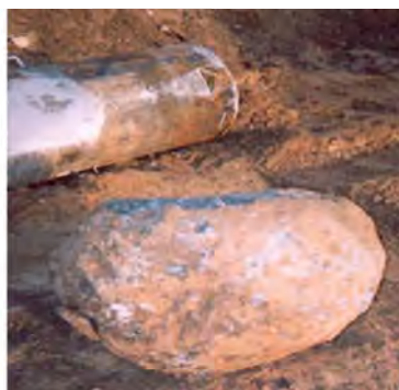
Рис.3. Труба-пята с глухим торцом и раскопанная пяты сваи
