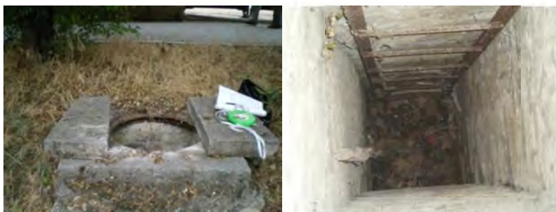
Рис. 6. Колодец дренажной системы Собора Святого равноапостольного князя Владимира
