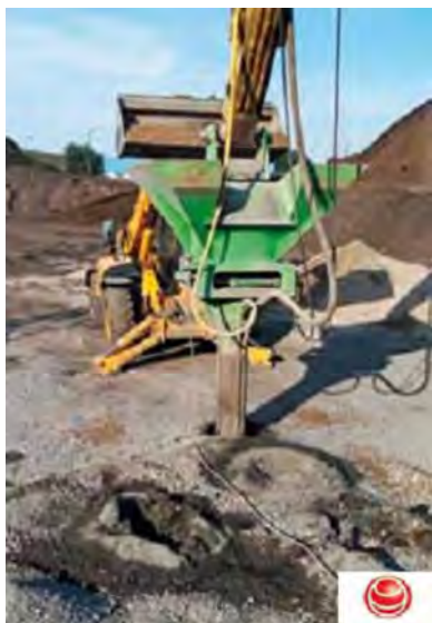
Рис. 5. Заполнение трубы, образуя агрегаты гравия колонны ноги (объезд Елку), источник: ООО Менард, Польша
