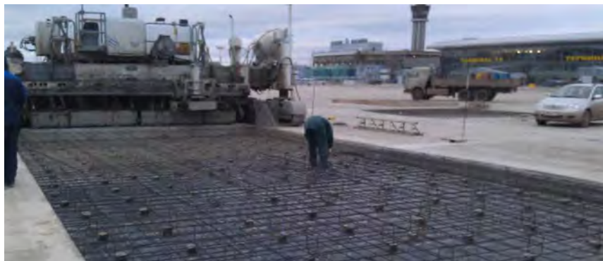
Рис. 1. Пример использования КН арматуры производства ООО НПФ «Уралспецарматура» для армирования перрона аэропорта
