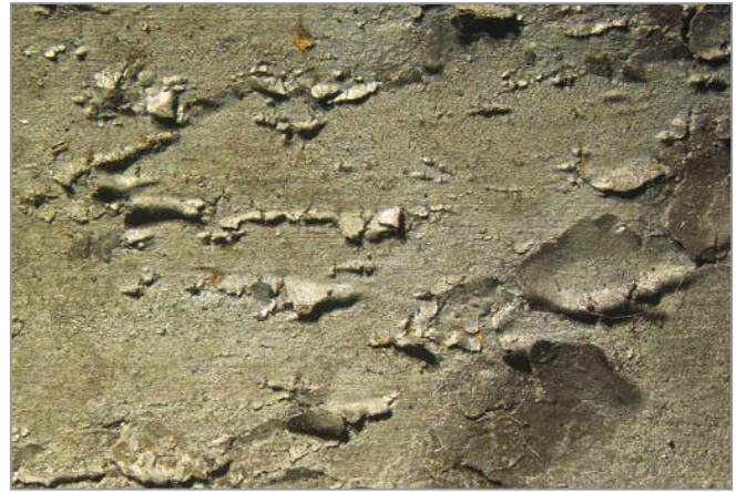
Рис. 1. Внешний вид сталеплавильных плен и вздутий по раскатанным дефектам макроструктуры непрерывнолитой заготовки на внутренней поверхности трубы
