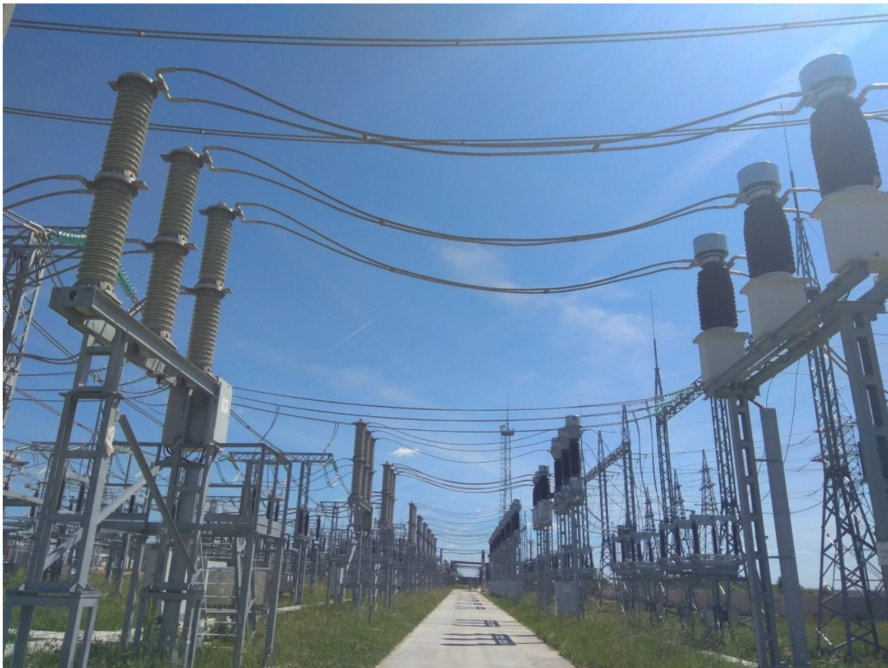
Рисунок 4 – ПС 330/110/10 кВ «Минск-Северная» [3]
