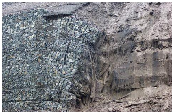
Рис. 8. Разрушение габионной подпорной стенки в результате допущения ошибок при проектировании или при монтаже конструкции
