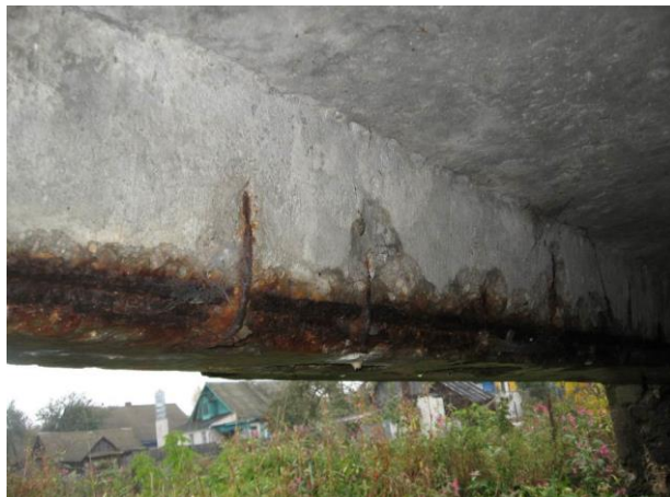
Рис. 2. Деструкция бетона ребристой плиты пролетного строения, оголение и коррозия арматуры
