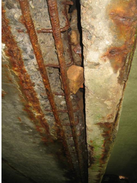
Рис. 3. Разрушение бетона плиты сплошного сечения, коррозия арматуры, выключение из работы крайнего стержня в результате потери сцепления с бетоном
