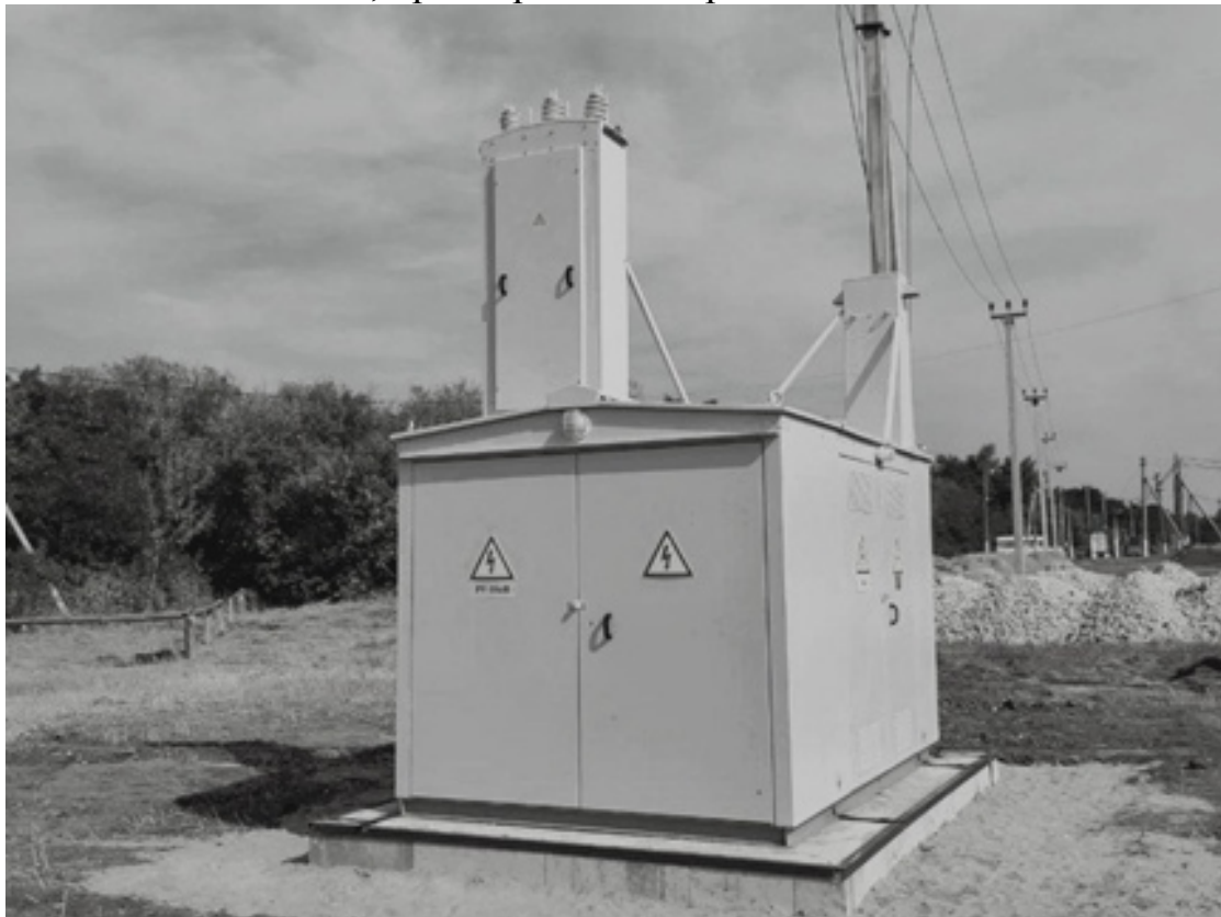
Рисунок 1 – Трансформаторная подстанция закрытого типа
