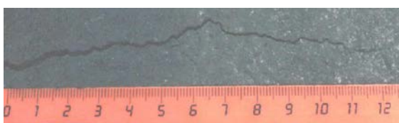
Рисунок – Зафиксированная трещина в плите
