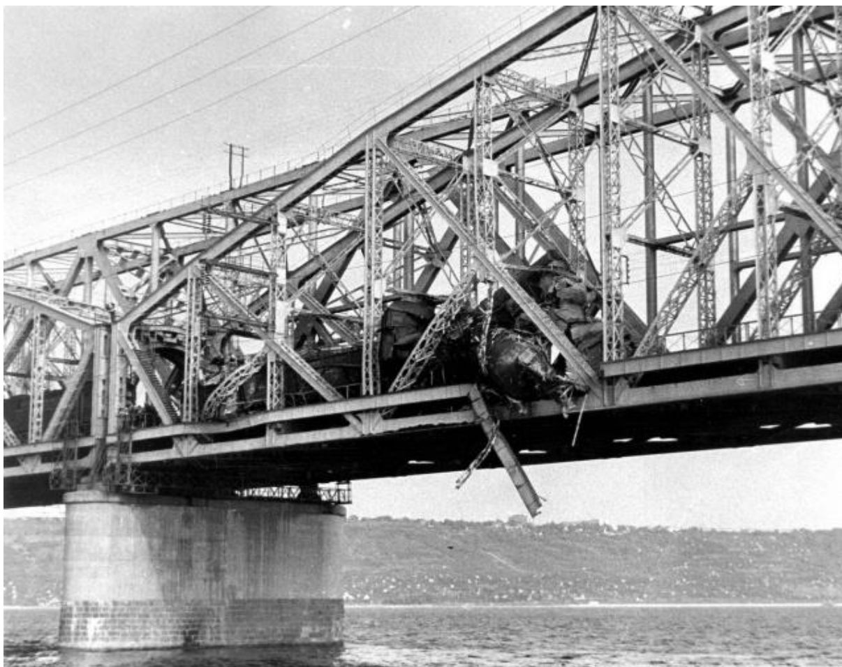
Рисунок 2 – Фотография восьмого пролета моста через Волгу после катастрофы
