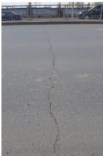
Рисунок 2 – Пример образование трещины на асфальтобетонном покрытии
