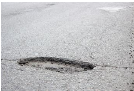
Рисунок 3 – Пример образования выбоины на асфальтобетонном покрытии
