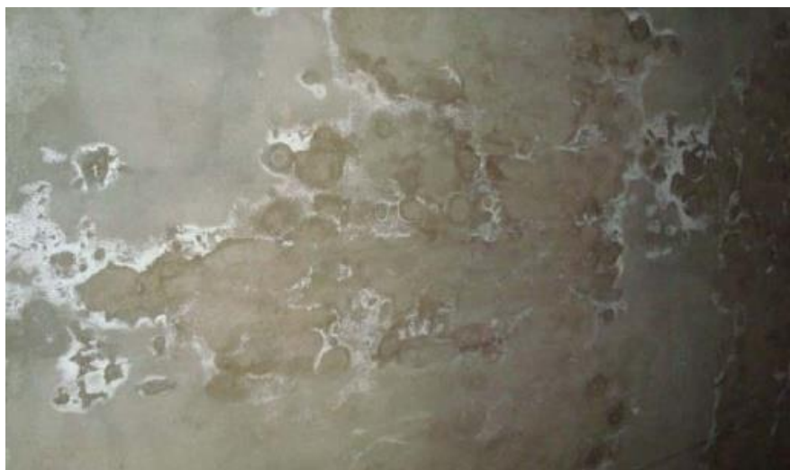
Рисунок 3 – Следы воздействия щёлочи на бетон
