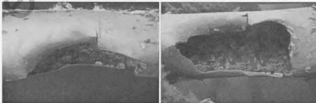
Рис. 1. Пример дефекта в подводной части конструкции морской платформы
