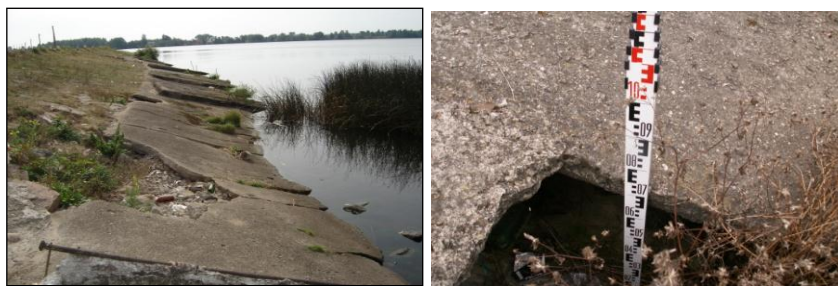
Рис. Характерные разрушения сборных и сборно-моноклитных креплений
