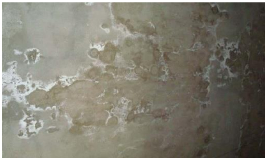
Рисунок 3 – Следы воздействия щёлочи на бетон
