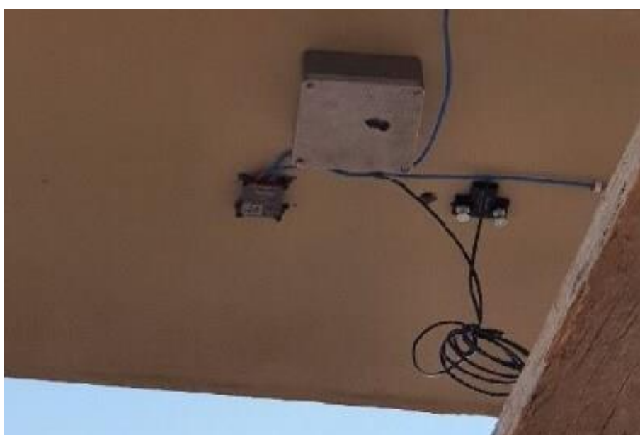
Рисунок 6 – Тензометрические датчики, установленные внизу балки пролетного строения
