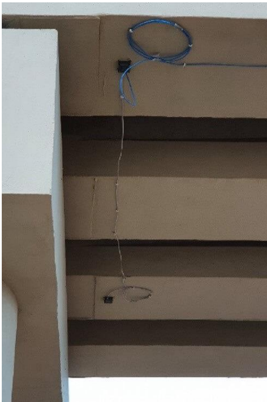
Рисунок 4 – Акселерометр, установленный на балках моста
