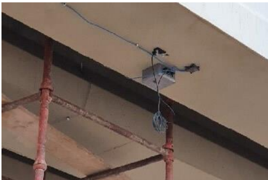
Рисунок 5 – Наклономер, установленный на балке моста
