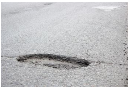
Рисунок 3 – Пример образования выбоины на асфальтобетонном покрытии
