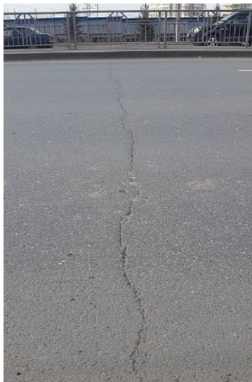
Рисунок 2 – Пример образование трещины на асфальтобетонном покрытии
