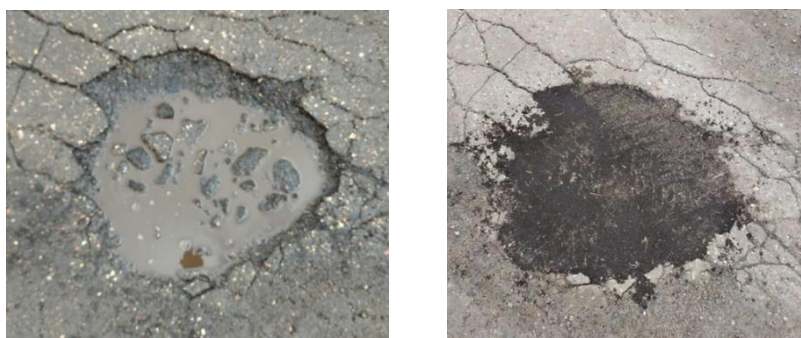
Рисунок 1 – Выбоины до и после ремонта
