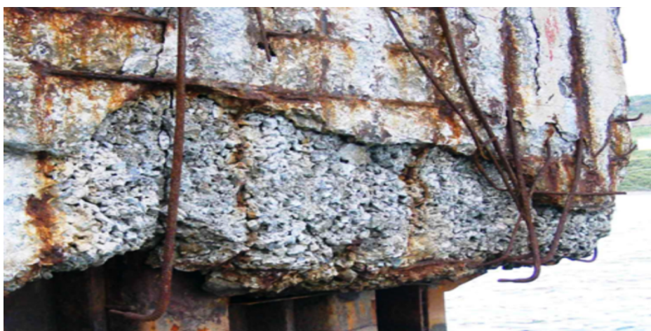
Рис. 1. Коррозия бетона лицевой стенки причала в порту Холмск [4] Данный процесс формирования электрохимических ячеек на поверхности арматуры называется депассивацией (рис. 2).
