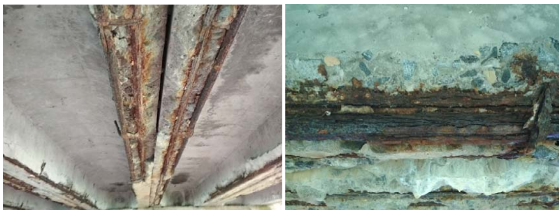
Рисунок 1 – Разрушение защитного слоя и пластовая коррозия арматуры
