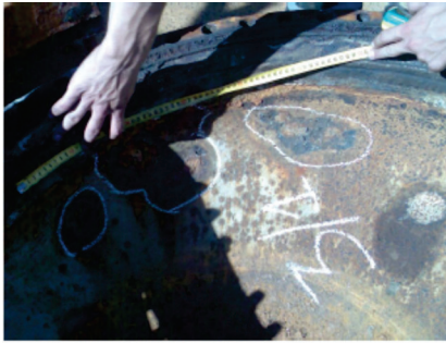
Рисунок 1 – Корозійні виразки на денці плавзоловки теплообмінника зі сталі 17ГС
