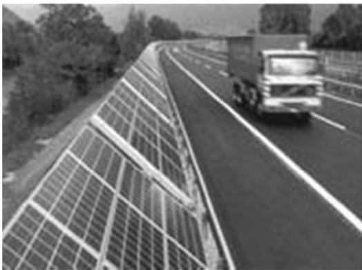
Рис. 1.6. Фотоэлектрическая станция вдоль обочины автотрассы
