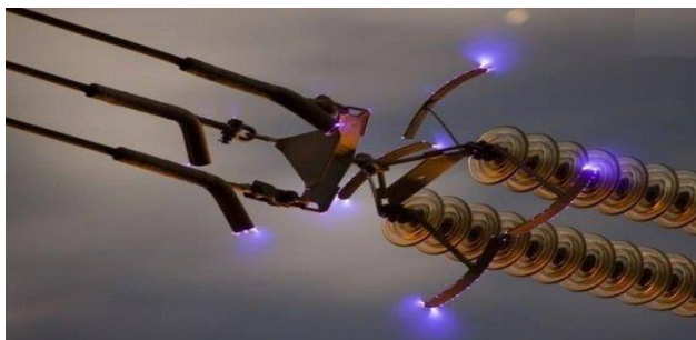
Рис.1. Коронный разряд на ЛЭП
