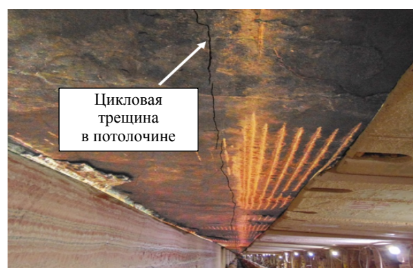
Рис. 3. Появление цикловых трещин в кровле призабойного пространства лавы № 3–13
