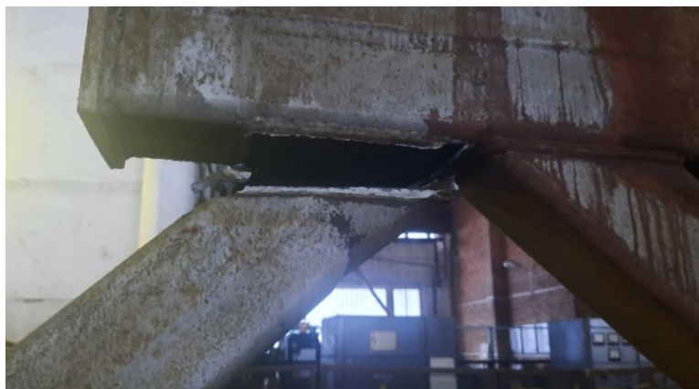
Рисунок 5. Разрушение по сварному шву опорного раскоса подстропильной фермы в зоне примыкания к нижнему поясу
