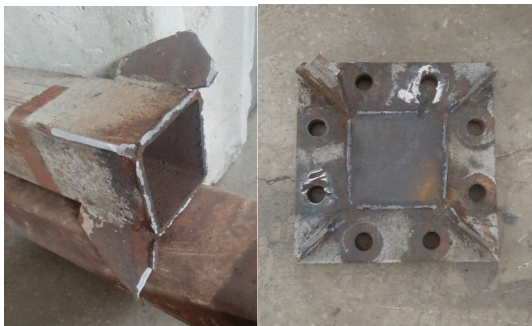
Рисунок 6. Разрушение по сварному шву по фланцу монтажного узла нижнего пояса стропильной ферм
