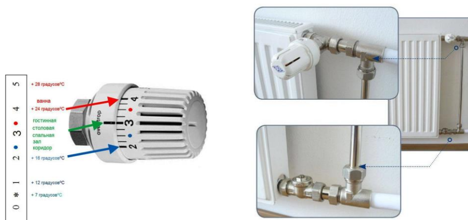
Рисунок 3.24 – Индивидуальный регулятор температуры для радиаторов отопления
