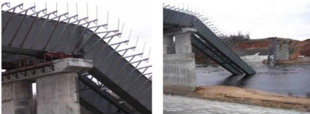
Рисунок 6.5. Вид надвигаемых конструкций после обрушения
