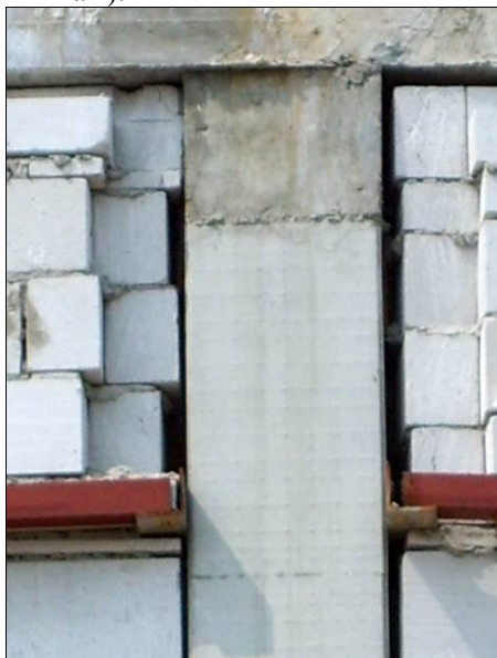
Рисунок 8. Фрагмент фасада строящегося дома со стенами из АГБ (консольный выступ стены 8-10 см)
