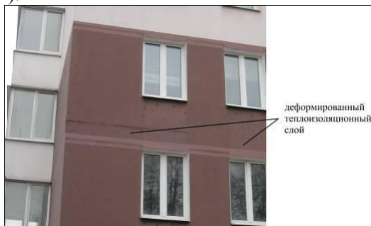
Рисунок 2. Фрагмент фасада нового дома со стенами из АГБ, утепленного в уровне перекрытия минераловатными плитами (ТИ слой деформирован)
