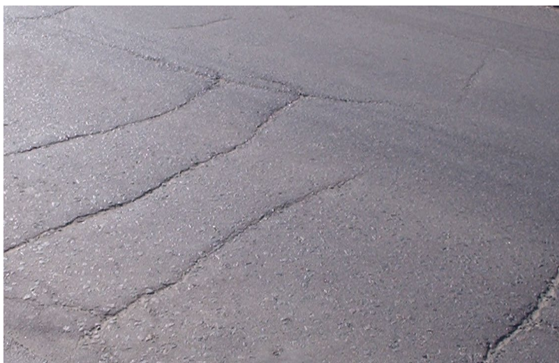
Рис. 1.3. Усталостное разрушение покрытия в виде сетки трещин «аллигаторного» типа
