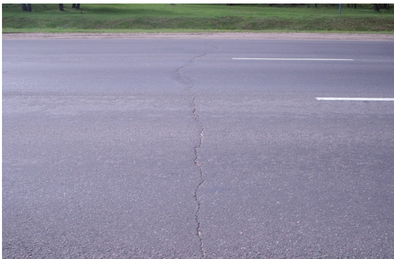
Рис. 1.4. Усталостное растрескивание покрытия природно-климатического характера в виде распространения поперечных трещин по всей ширине проезжей части
