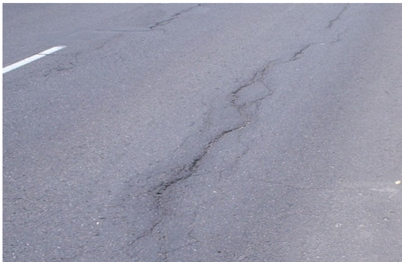
Рис. 1.2. Продольное трещинообразование усталостного характера
