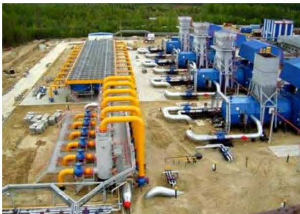
Рис. 2.22. Вид газораспределительной станции
