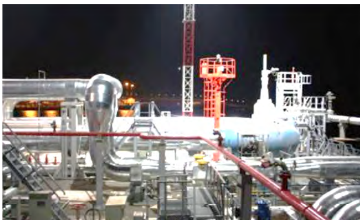
Рис. 2.23. Вид начальной станции нефтепровода
