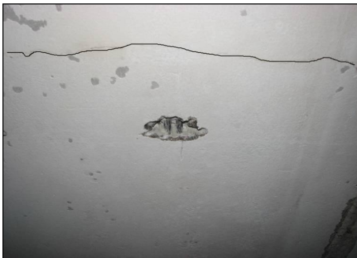
Рисунок 5. Поперечные трещины в плитах перекрытия
