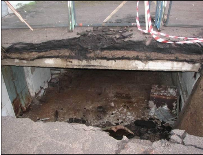
Рисунок 1. Участок обрушение плит перекрытия
