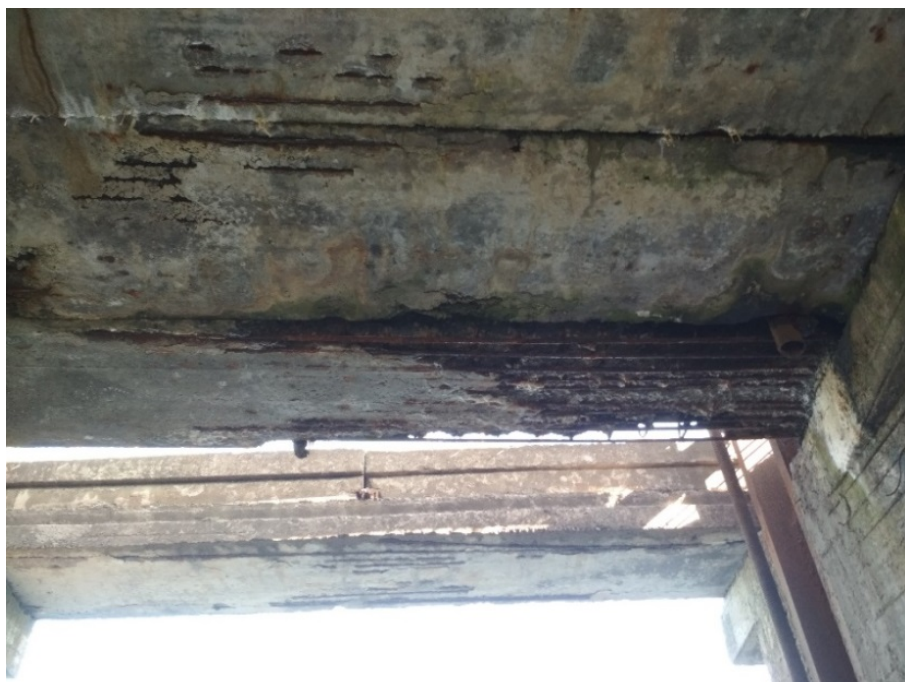
Рис. 10.1. Разрушение плитного пролетного строения
