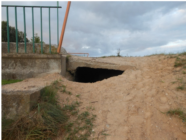
Рисунок 4.1. Разрушение сопряжения моста с подходами (фото автора)
