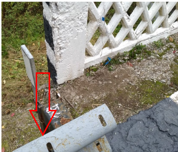
Рисунок 2.1 – Временный репер ВР1. Верх первой стойки барьерного ограждения в начале моста слева
