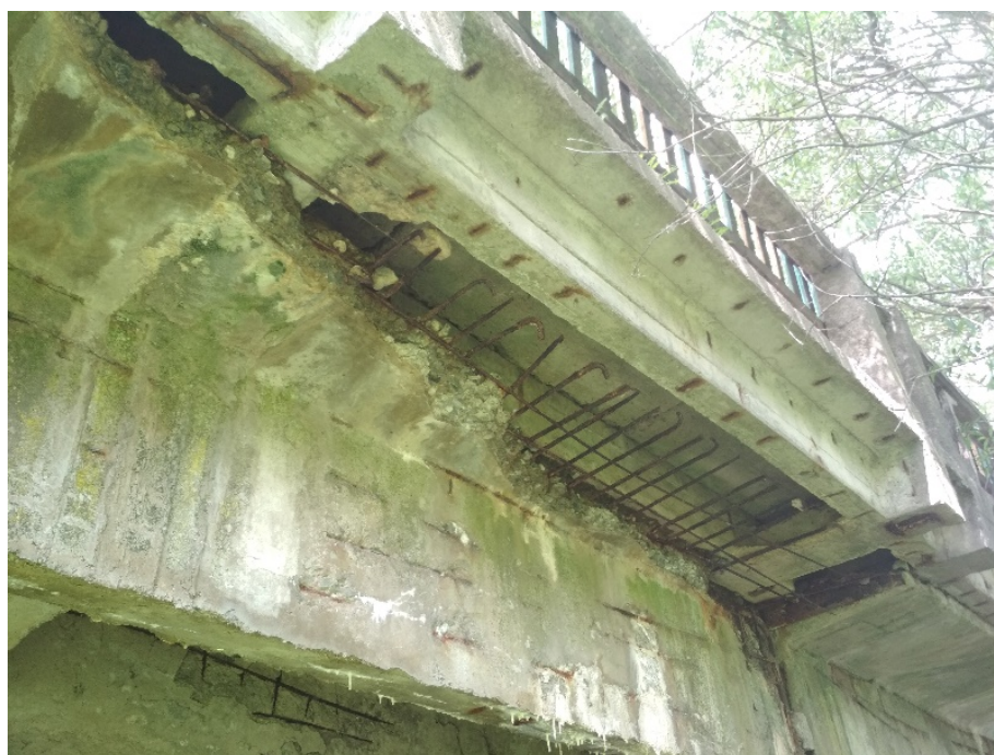
Рис. 10.2. Разрушение балки пролетного строения под тротуарным блоком
