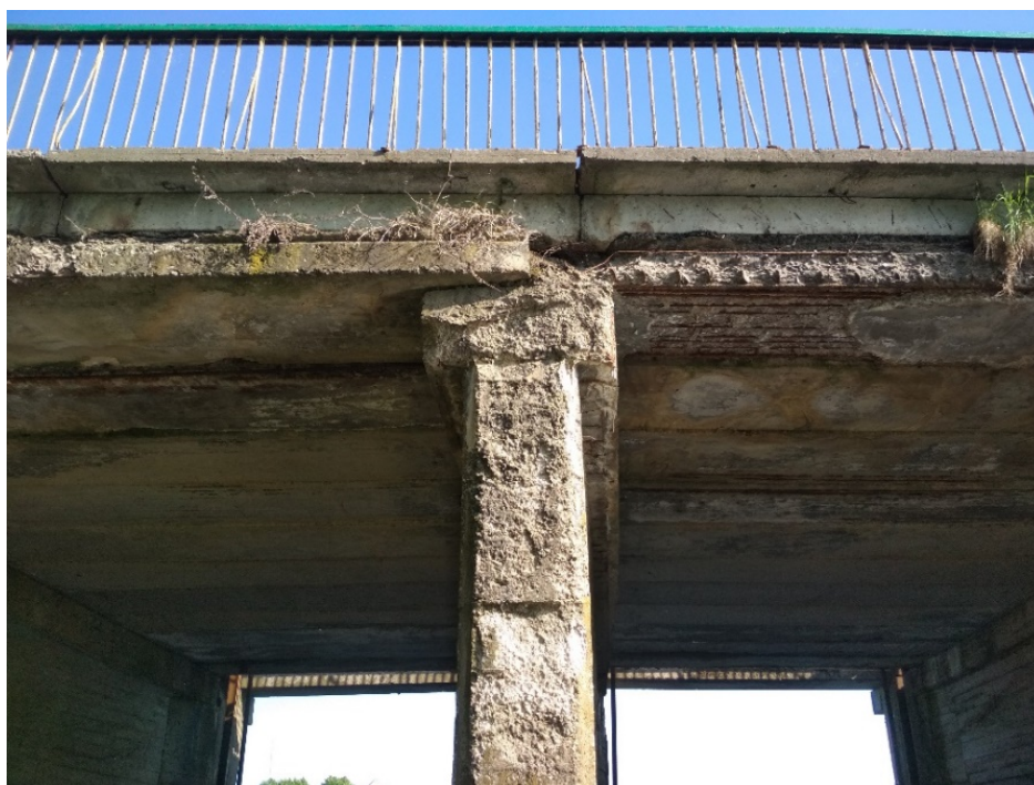
Рисунок 3.1. Разрушение защитного слоя и коррозия арматуры (фото автора)
