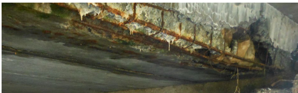
Рисунок 3.3. Разлом по ребру плиты – АВАРИЙНАЯ СИТУАЦИЯ . Размораживание с оголением арматуры. Поражение рабочей арматуры плиты в расчетных сечениях коррозией (фото автора)
