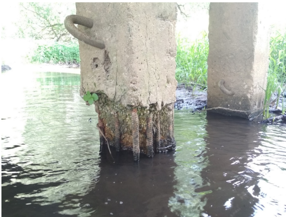
Рисунок 3.2. Разрушение бетона сваи, оголение и коррозия арматуры (фото автора)
