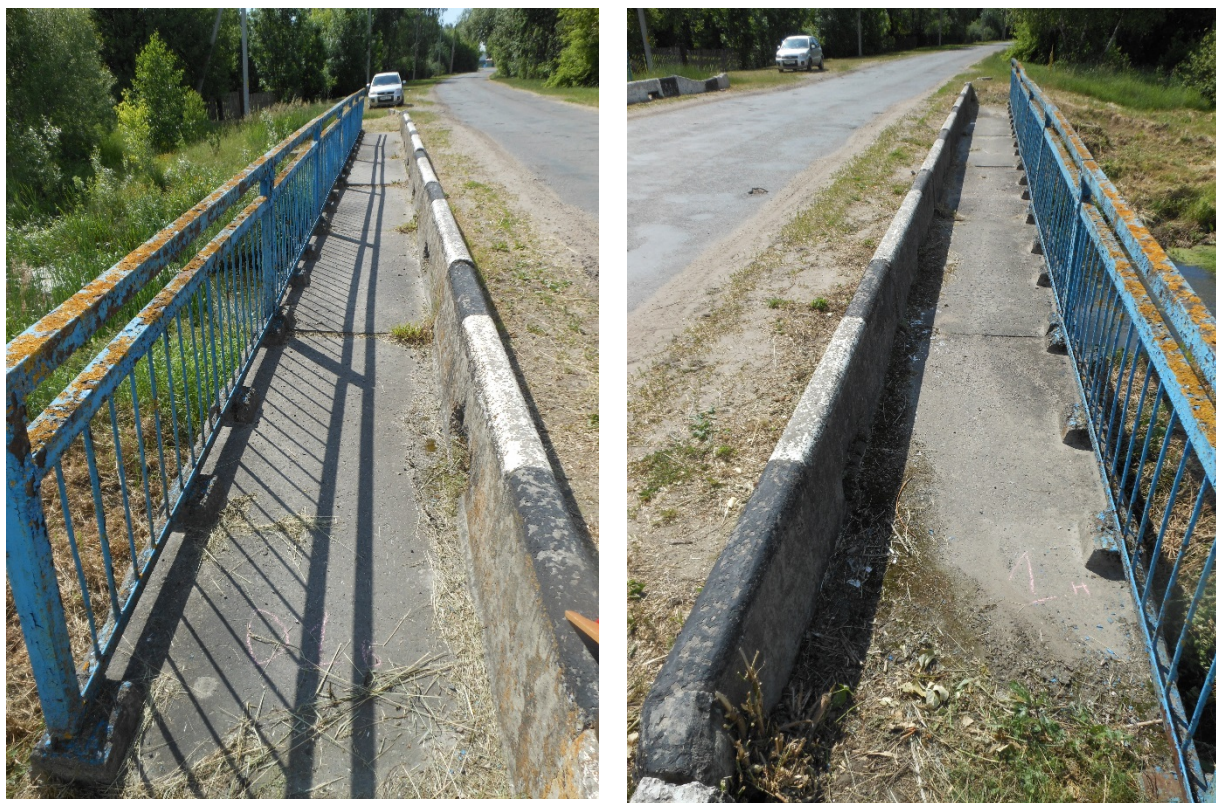
Рисунок 9.2. Коррозия перильного ограждения (фото автора)
