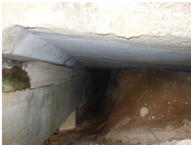
Рисунок 4.2. Разрушение сопряжения моста с подходами. Изменение расчетной схемы (фото автора)
