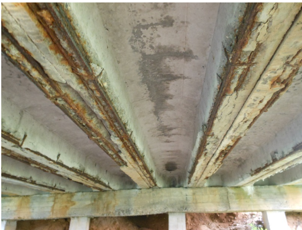
Рис. 10.3. Разрушение плитно-ребристого пролетного строения
