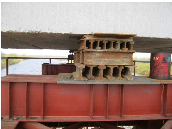
Рис. 6.4. Узел опирания пролетного строения на временную опору: 1 – пролетное строение; 2 – клетка из обрезков рельсов; 3 – гидравлический домкрат; 4 – распределительная двутавровая балка
