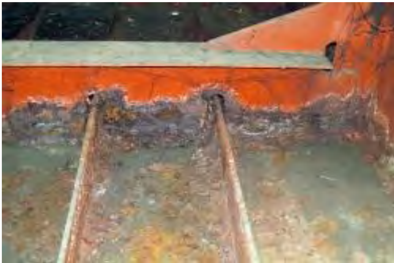
Рисунок 2 – Загрязнение и пластинчатая коррозия элементов нижней плиты внутри правой коробки металлического пролетного строения
