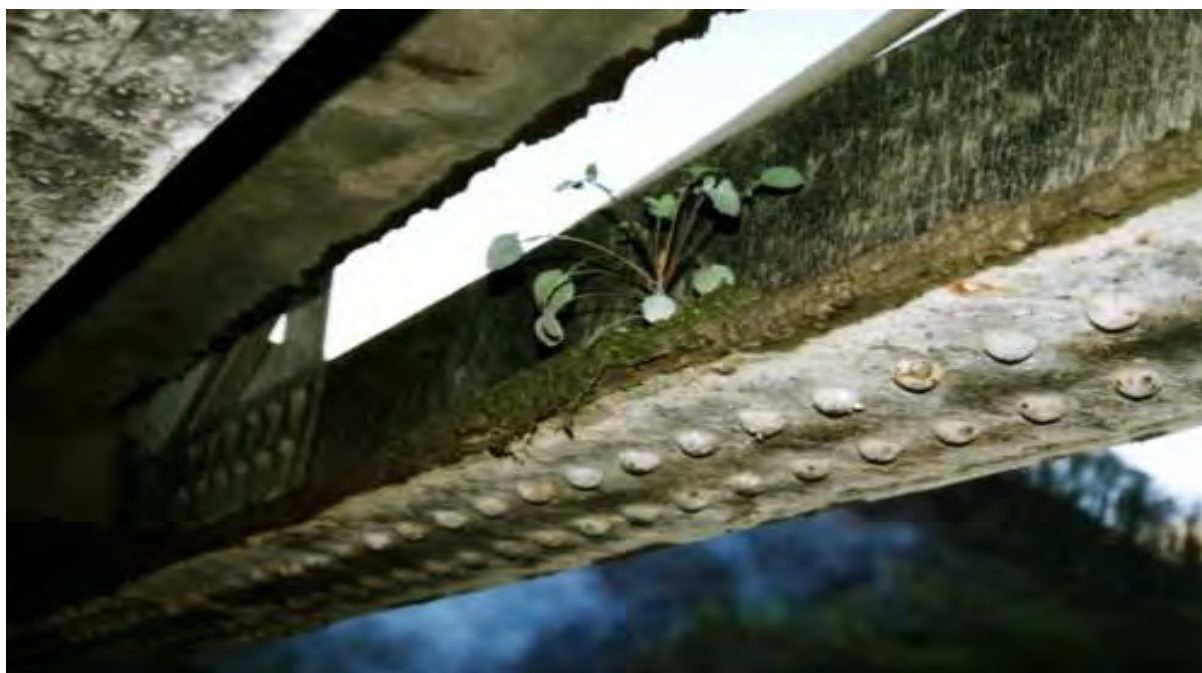
Рисунок 1 – Растение и грязь на нижнем поясе правой фермы металлического пролетного строения моста
