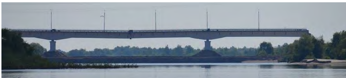
Рисунок 1 – Аварийный мост на реке Припять между Житковичами и Туровом. Разрушение центрального пролёта
