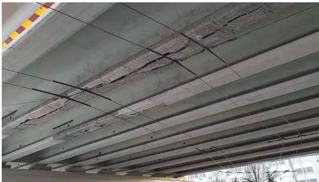
Рисунок 1 – Мост в аварийном состоянии
