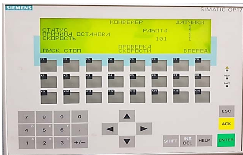
Рис. 56. Панель управления SIMATIC OP17 в рабочем состоянии
