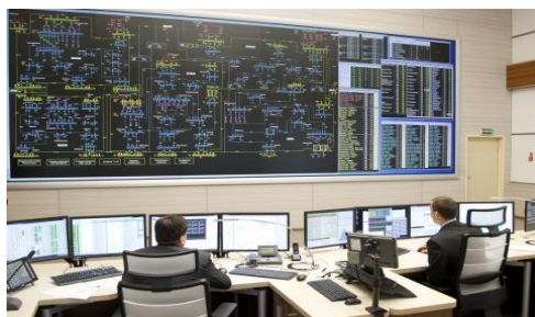
Рис. 5. Диспетчерское управление системой теплоснабжения
