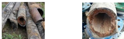
Рис. 1. Демонтированные трубы с отложениями на внутренней поверхности
