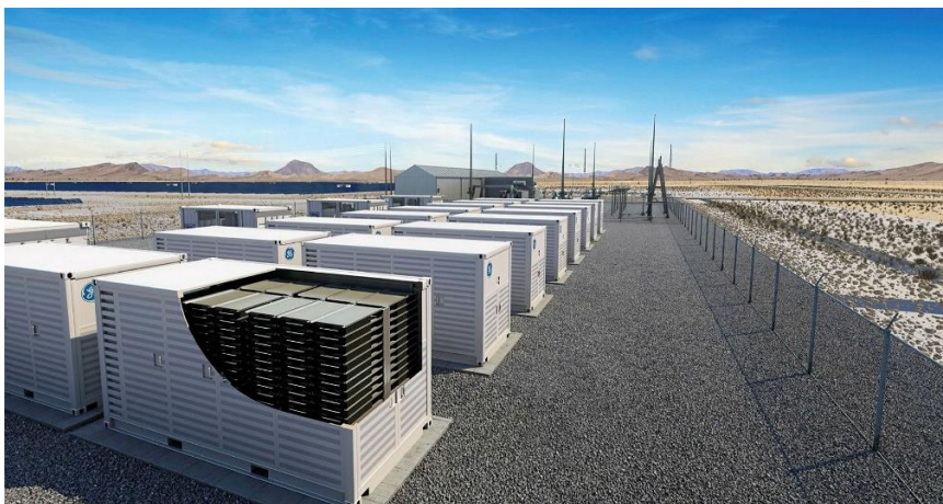
Рисунок 1 – Энергохранилище «Tesla» в Австралии
