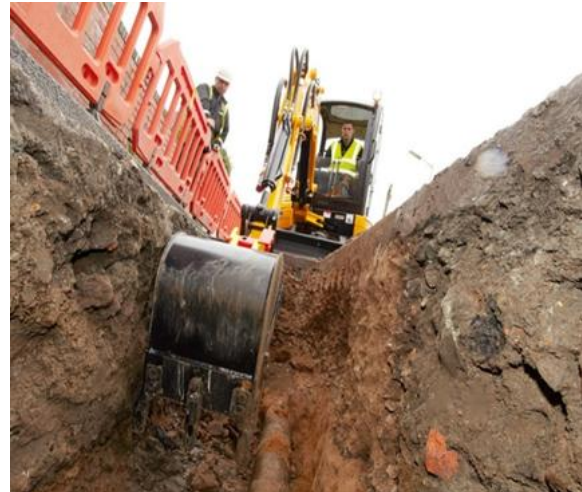
Рисунок 2 – Повреждение КЛ из-за воздействия сторонних лиц ввиду отсутствия достоверных данных о расположении трубного кабельного канала, проложенного методом горизонтальное направленное бурение (ГНБ)
