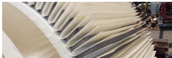
Рис. 1. Хлопчатобумажная изоляция в пазах ротора [2]
