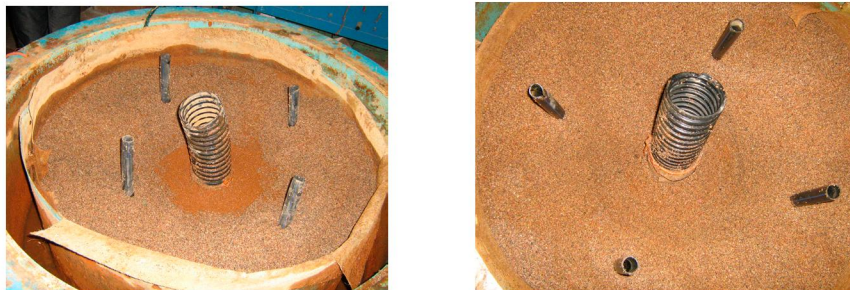
Рис. 6. Прифильтровая зона скважины до и после регенерации
