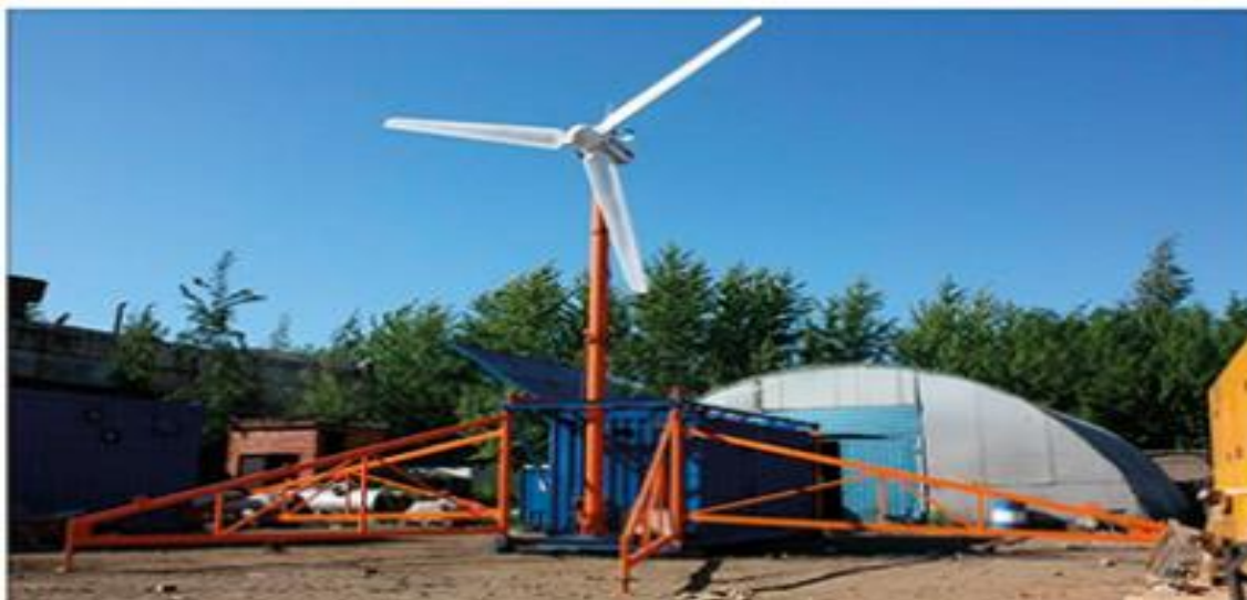
Рисунок 2 – Контейнерная электростанция блочного исполнения мощностью 16 кВт
