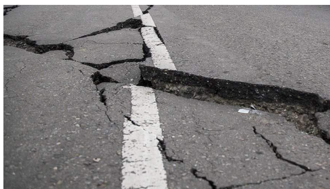
Рисунки 4 – Пример разрушения дороги от 5 -7.7 баллов
