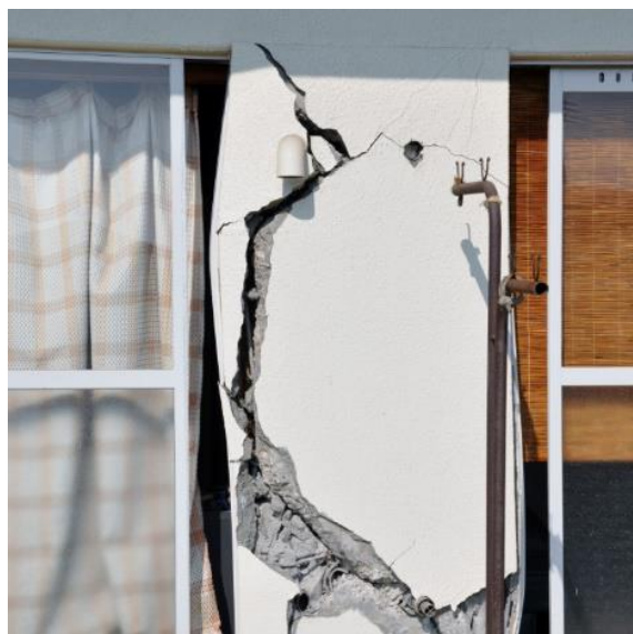
Рисунок 3 – Пример разрушения колонны здания от 5 - 7.7 баллов
