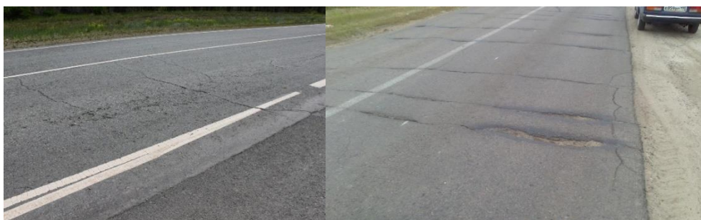
Рисунок 2 – Усталостные трещины (слева), температурные трещины (справа)
