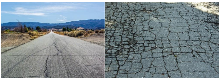
Рисунок 1 – Отраженные трещины (слева), силовые трещины (справа)
