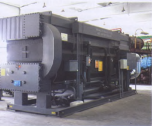
Общий вид абсорбционной установки
