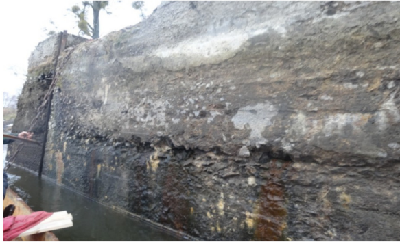
Рисунок 8 – Разрушения продольной стенки левобережного устоя
