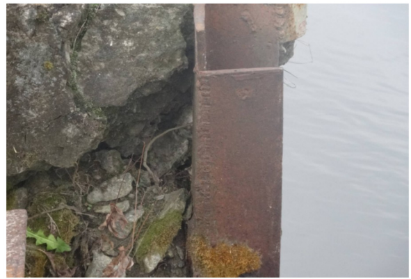
Рисунок 5 – Разрушения в бетоне и оголение арматуры на контакте с закладными частями
