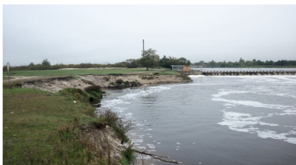
Рисунок 10 – Размыв правобережного откоса
