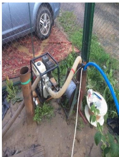
Рисунок 3 – Общий вид оборудования при гидравлических исследованиях двухколонной скважины
