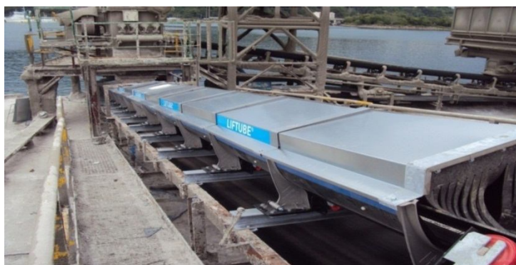
Рис. 8. Установка защиты от пыления на ленточный транспортер
